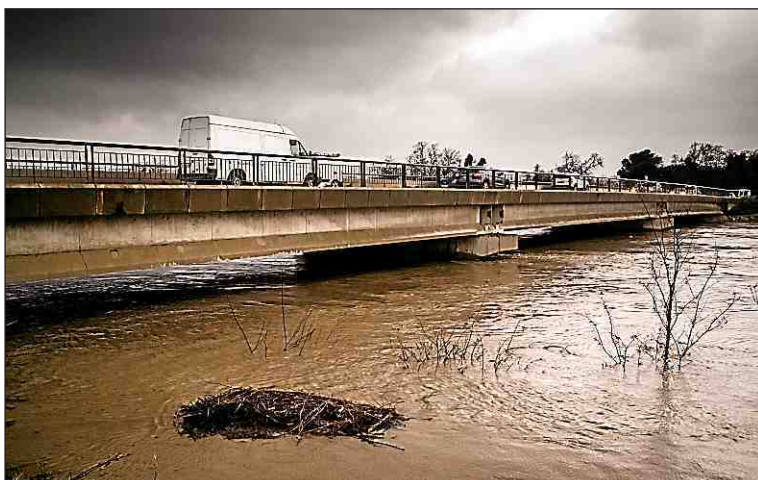
Le même pont lors de la crue de janvier 2020.
