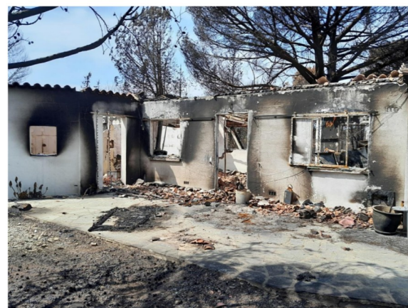
Construction détruite par le feu - niveau de dégât maximal- niveau 5
